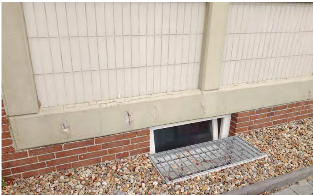
Abb. 5.3/1 Risse und freiliegende Bewehrung an der Fassade des Rathauses (Marktstraße 8)
