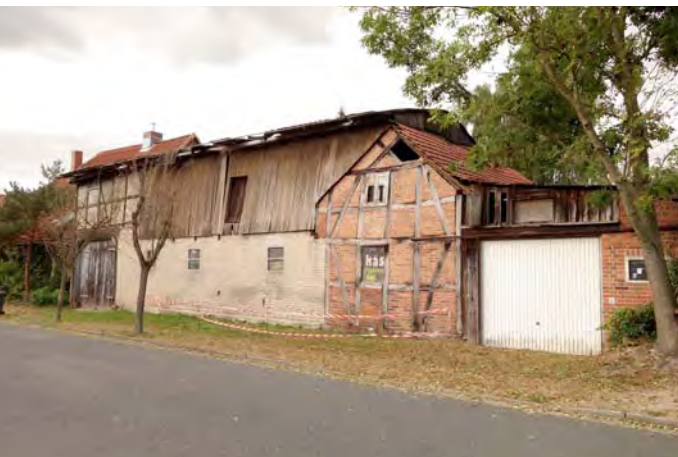
Abb. 3.3/2 Teile des Gebäudes Mittelstraße 10 sind augenscheinlich einsturzgefährdet.
