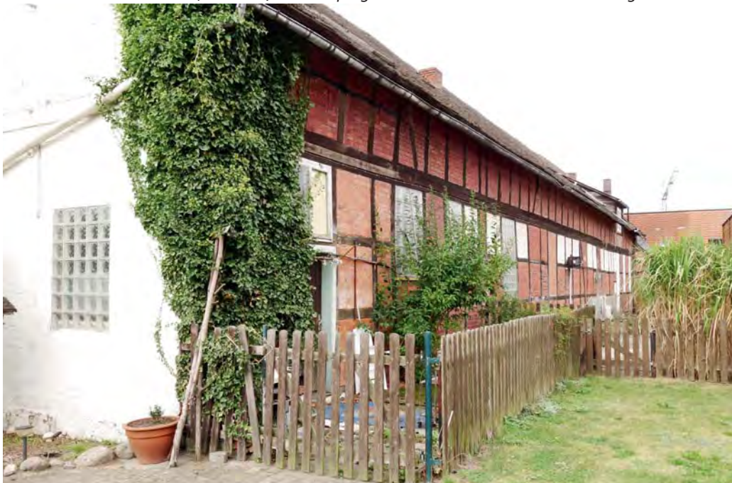
Abb. 2.7/1 Lindenstraße 11 (Rückseite): Ortsbildprägendes Gebäude mit hohem Sanierungsbedarf
