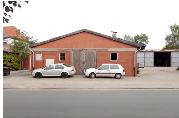
Abb. 5.6/1 Sanierungsbedürftiges Lagergebäude von Lindenstraße 17
